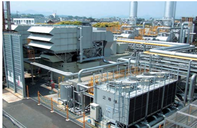
コージェネレーションシステムの外観
