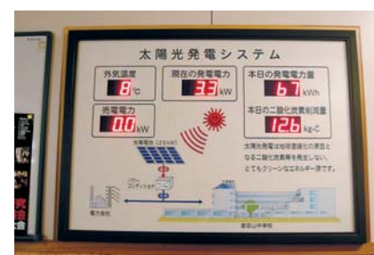
発電状況表示盤
