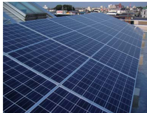
太陽光発電システム
